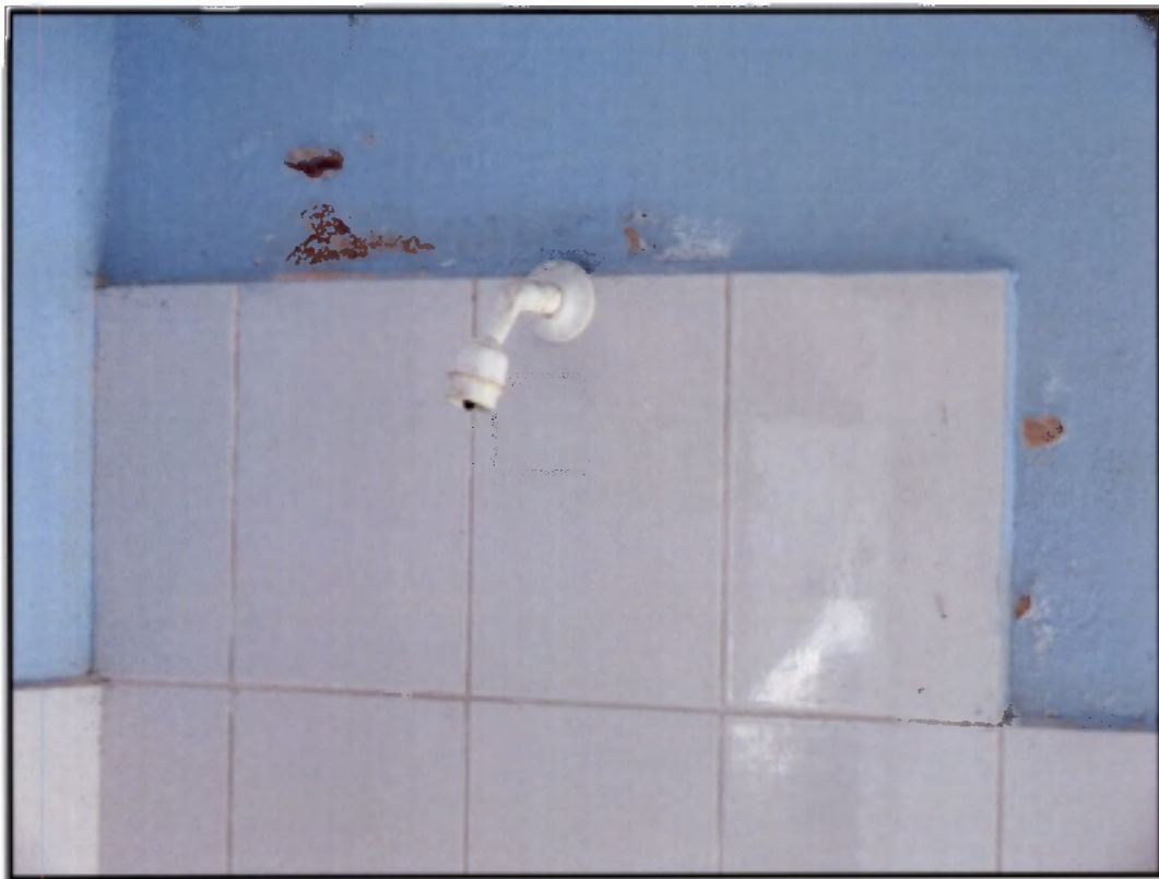
Fotografía No. 17 Desprendimiento de pintura
