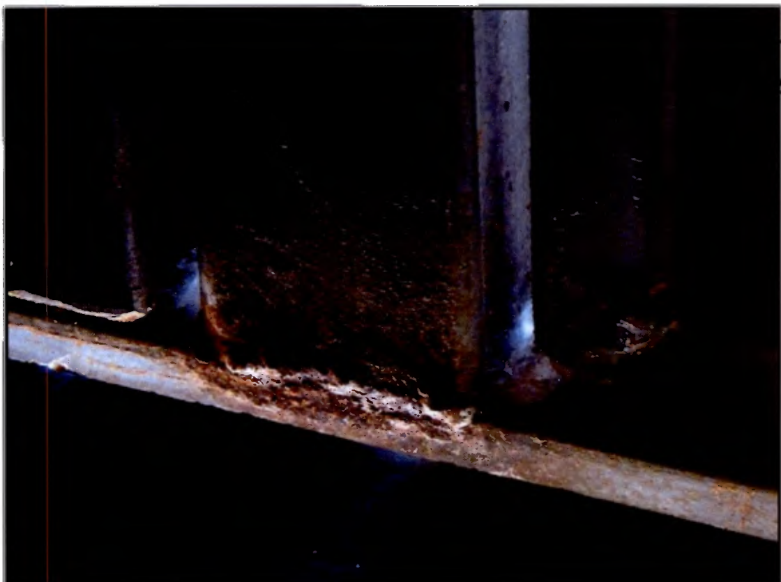
Fotografía No. 16 Una sola capa de pintura y rastros de oxido.
