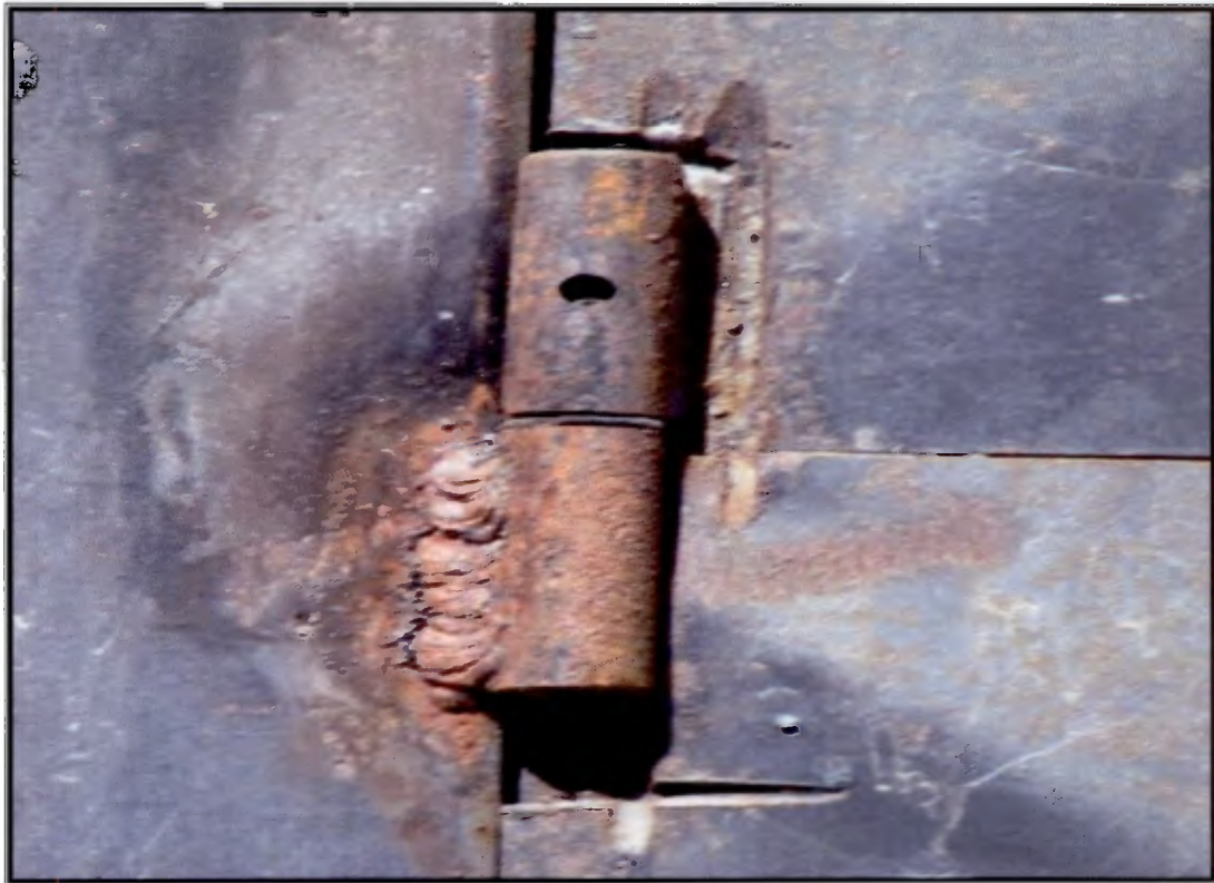
Fotografía No. 15 Una sola capa de pintura y rastros de oxido.
