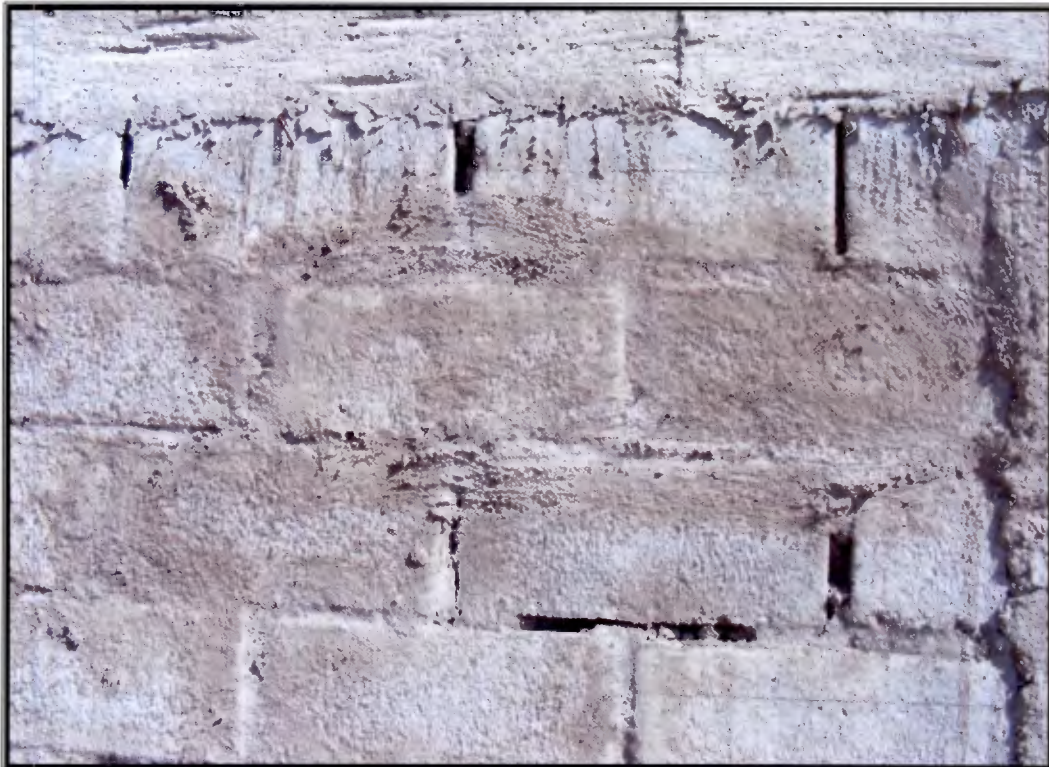
Fotografía No. 4 Falta de mortero de unión vertical entre algunos bloques del muro.
