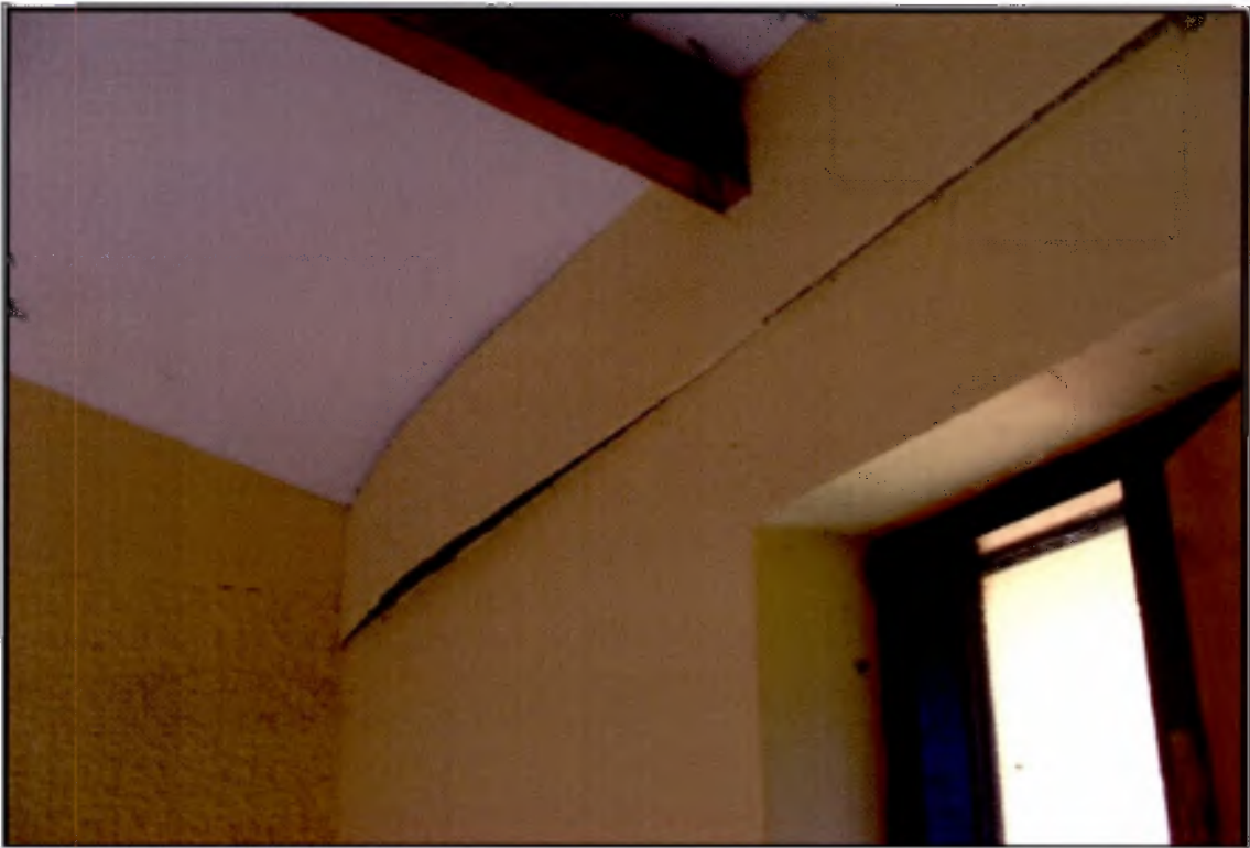
Fotografía No. 13 Desprendimiento del fibrocemento
