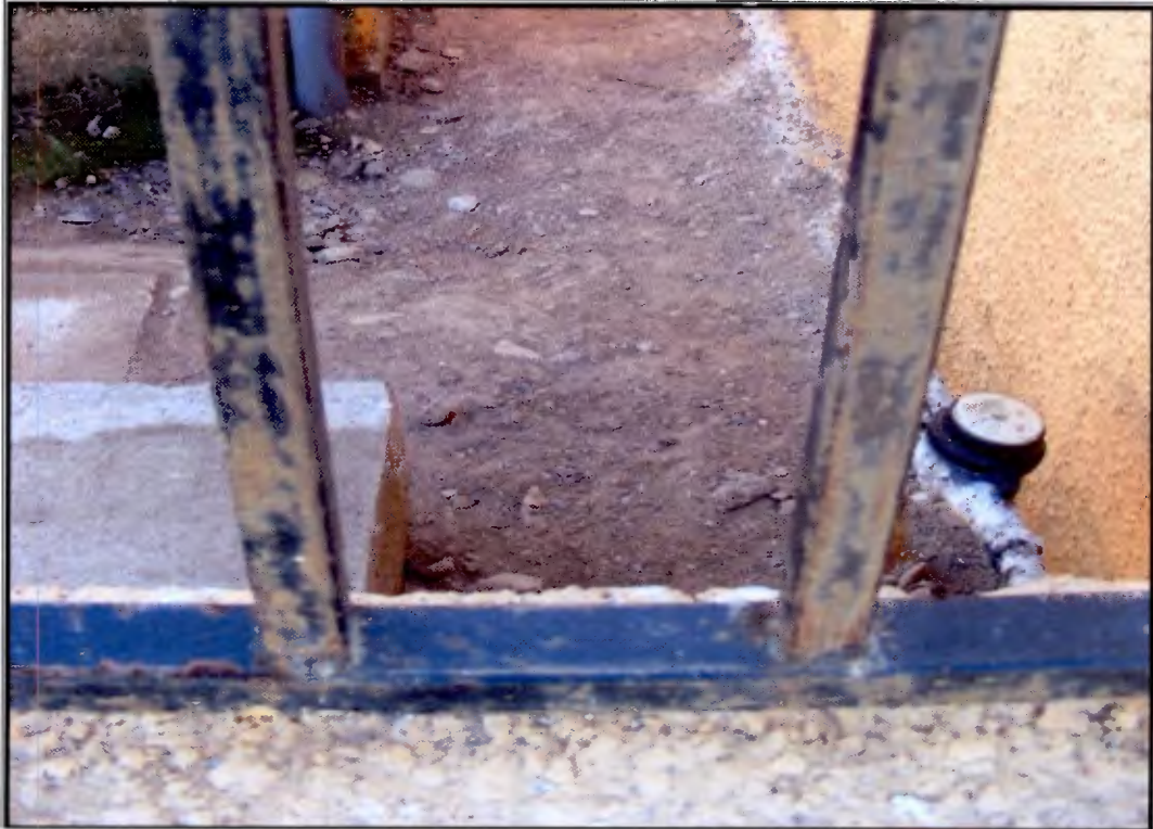
Fotografía No. 1 Una capa de pintura y rastros de oxido
