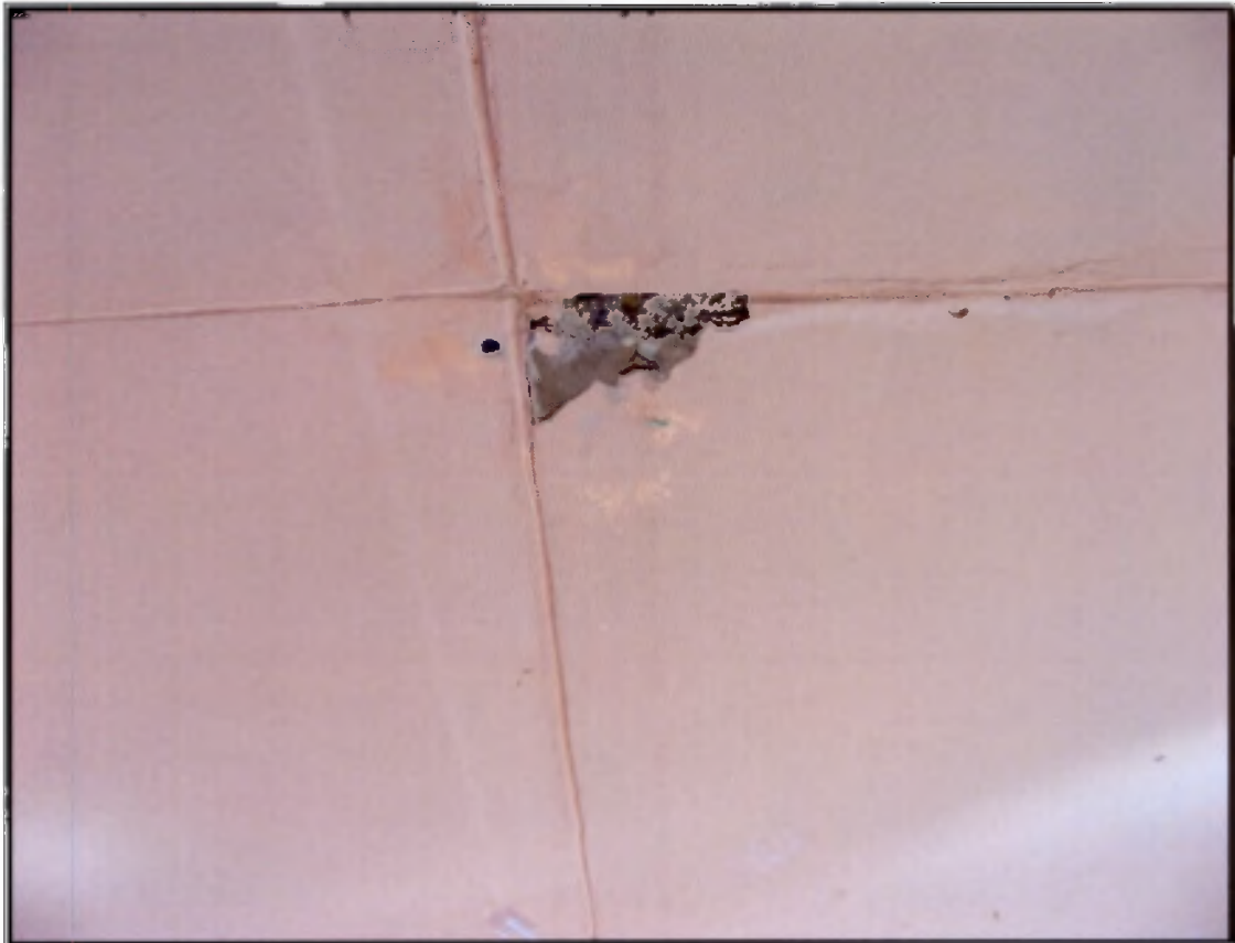
Fotografía No. 5 Mala ejecución del cielo
