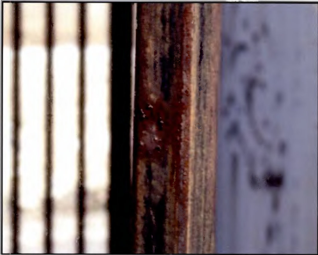
Fotografía No. 3 Una sola capa de pintura y rastros de oxido.
