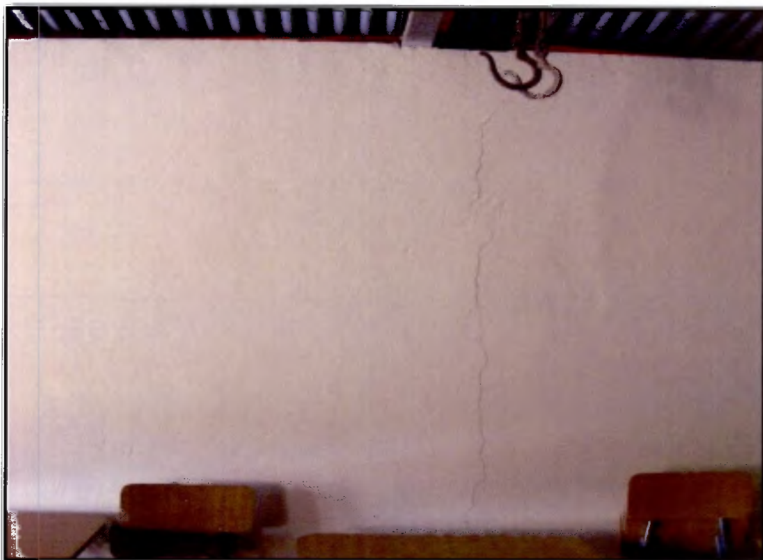
Fotografía No. 9 Fisura en muros
