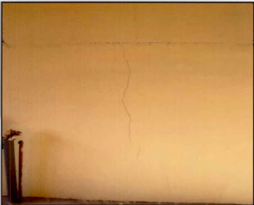
Fotografía No. 14 Grieta en el muro.
