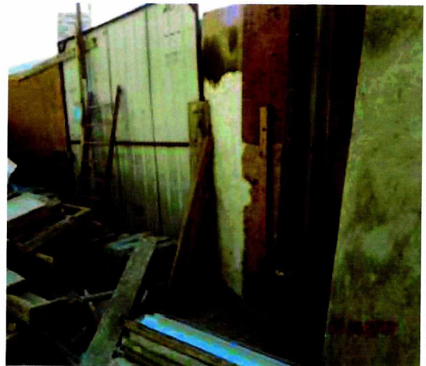
Fotografía N° 28: El cierre no cumple con la altura y material especificado.
