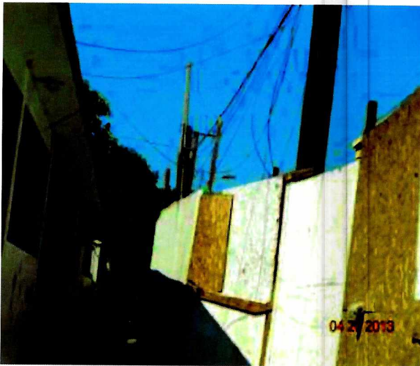
Fotografía N° 27: El cierre no cumple con la altura y material especificado.
