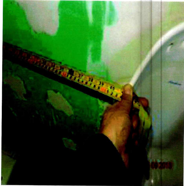
Fotografía N°25: Medida tomada en el lugar no concuerda con el proyecto.
